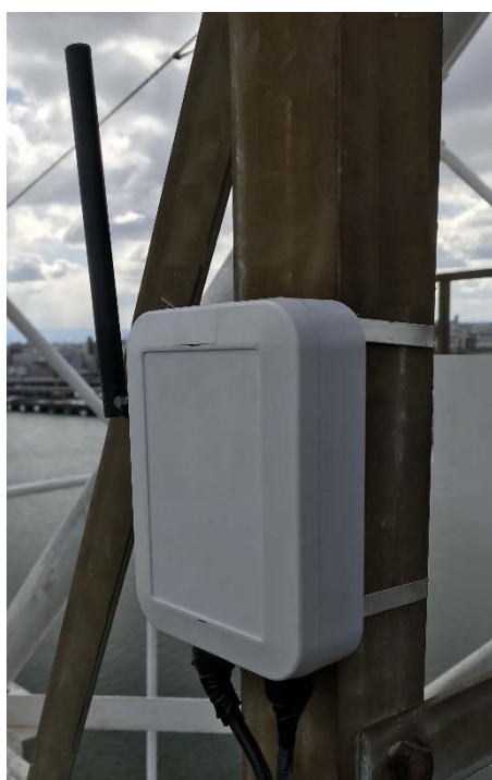
IoTゲートウェイ設置状況
