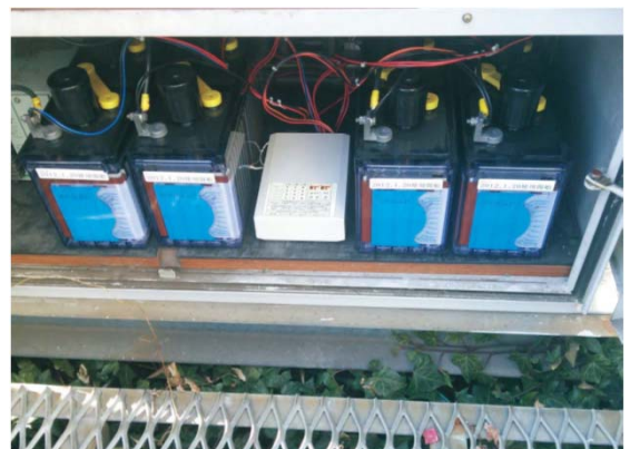
蓄電池の劣化監視
