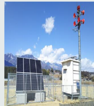
オフグリッド電源システム
