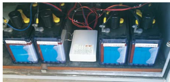
踏切器具箱設置例
