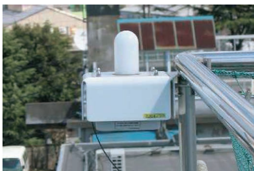
ビル屋上のフェンスに設置
