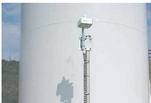
風力発電の塔脚に設置
