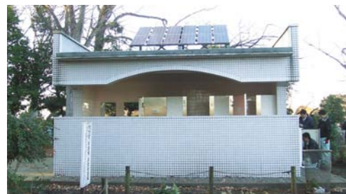
公共施設のトイレ(太陽光発電・蓄電システム)
